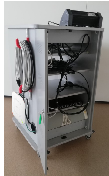
Vue arrière armoire multimédia et switch 16
